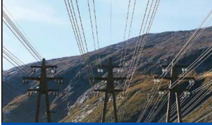
Enerji Hattı Kontrolü
