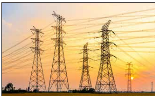
电力架空线监测
